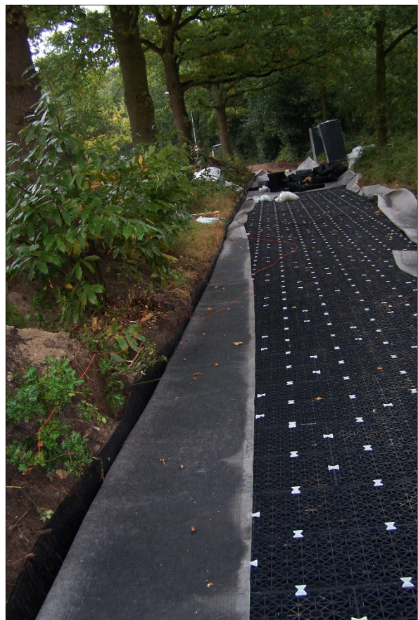
Afbeelding 2 Aanleg Permavoid kratten ter hoogte van het nieuwe fietspad. Zo ontstaat een draagkrachtige fundering die voor water- en zuurstoftoevoer zorgt voor de boomwortels
